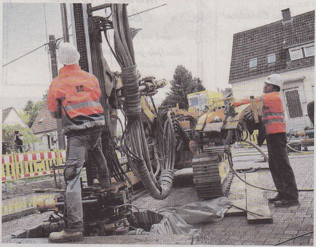
Bergschaden-Sanierung in einer Dortmunder Siedlung: 35 000 Fälle werden der RAG jährlich gemeldet. Foto dpa
