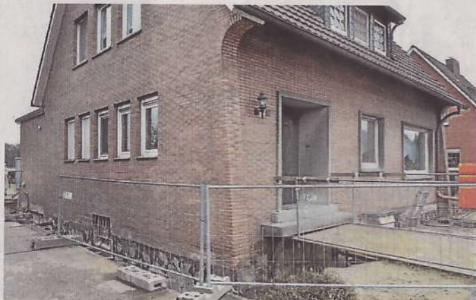
Bergbaugeschädigte Häuser sind in Lippramsdorf keine Seltenheit: Hier ein Haus in der Straße Im Winkel. Die Arbeiten kosteten 280 000 Euro.
