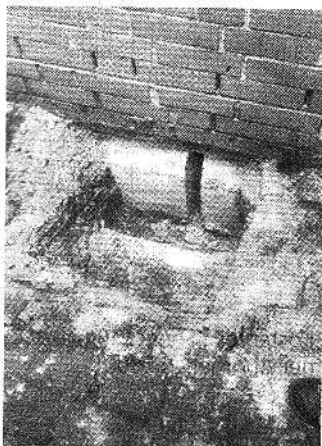
Sehr deutlich ist der Riss im Streifenfundament zu erkennen.
