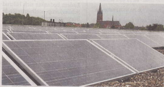
Photovoltaikanlage auf vier Schulzentrumsdächern.
